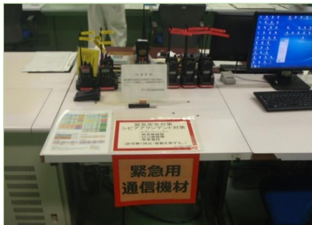
【改善】保管場所を当直員の作業机(常に見える位置)に変更し識別表示
